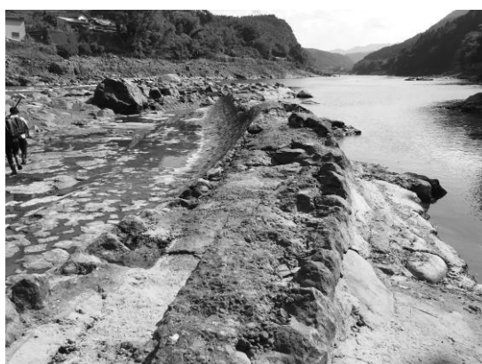
図-9 間知石の剥離部
