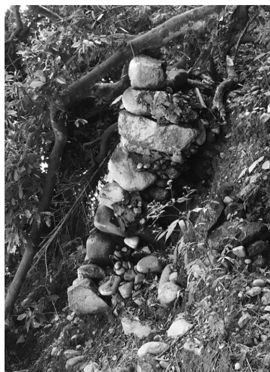
図-23 石積み破損部
