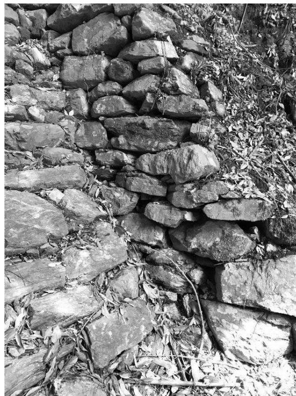
写真-4 流水部の床面石材を側面の石材が挟み込む
