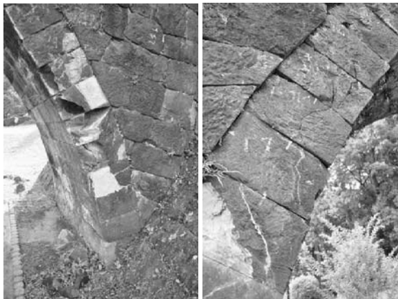
写真-11 西側橋台付近 写真-12 輪石のずれ・亀裂 （撮影：本田、2016. 09. 21）
