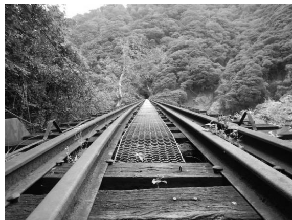
写真-4 変形した橋面の部材 （撮影：阿部、2016. 09. 04）
