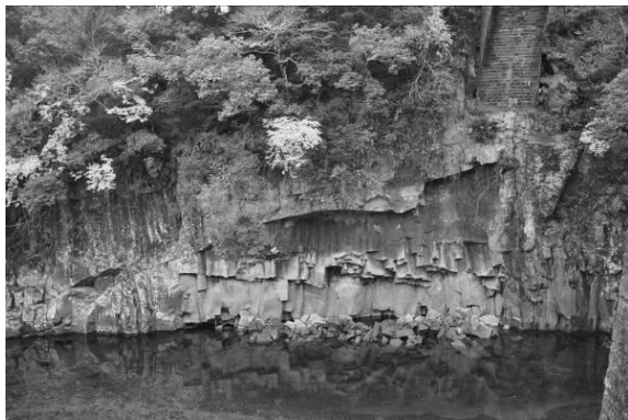
写真-29 崩落部の様子（写真右上が橋台） （撮影：本田、2016. 11. 29）
