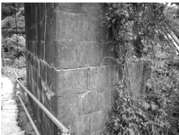
写真-6 立野側橋脚の剪断破壊 （撮影：阿部、2016. 09. 04）
