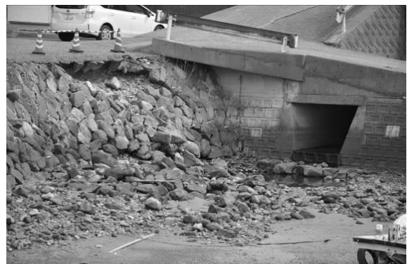
写真-16 干潮時の崩落部（撮影：本田、2016. 12. 18）
