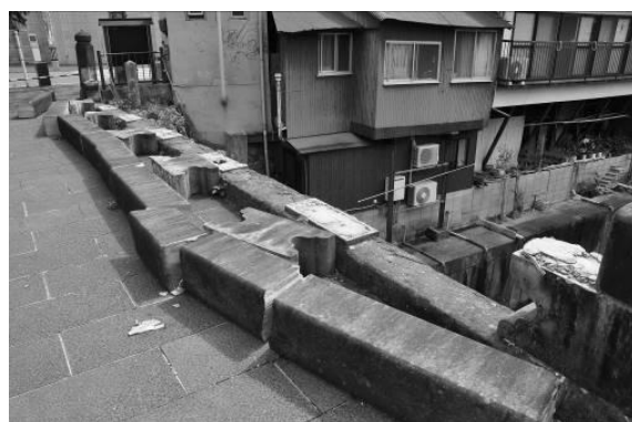
写真-8 倒壊した高欄（上流側） （撮影：本田、2016. 05. 25）
