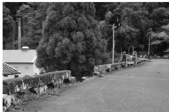
写真-14 下鶴橋の高欄落下箇所（上流右岸側） （撮影：本田、2016. 09. 20）
