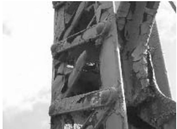
図10 上弦材に近く支材との取り合い箇所付近の垂直材レーシングバーの破断がみられる
