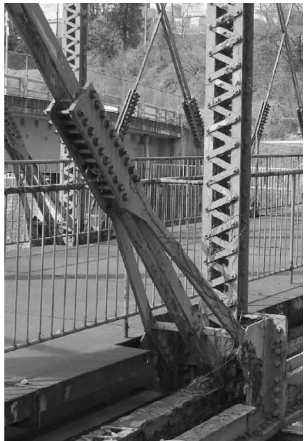
図7 補強された斜材
