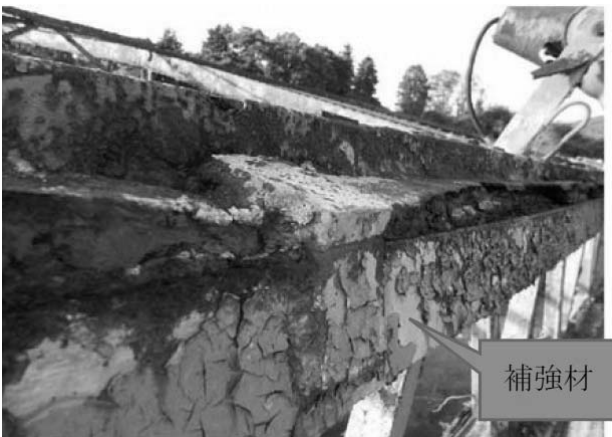
図 13 橋門構造水平支材トラスの上弦材の劣化状況 側面にアングル材が補強材として添えられている。
