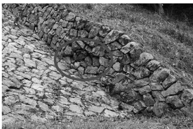
写真-3 崩壊前にみられた側壁の凹み
