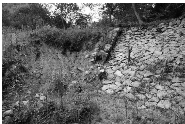
写真-2 土堤と水通し側壁が崩落した五番砂留
