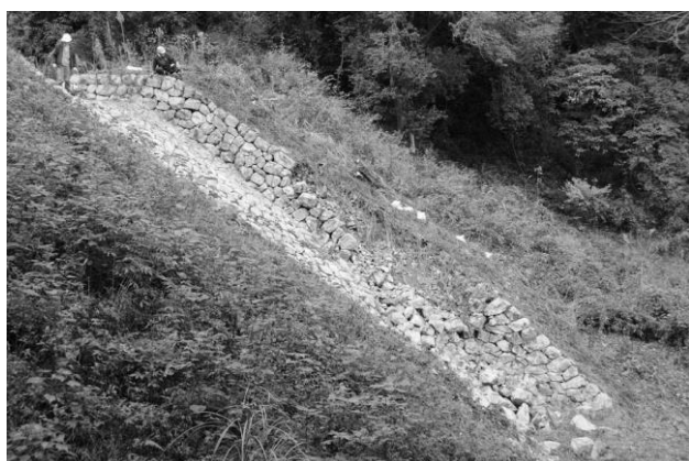
写真-1 崩壊した七番砂留の左岸側水通しの側壁
