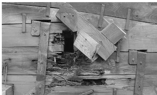
写真-3 アーチリブの腐朽状況
