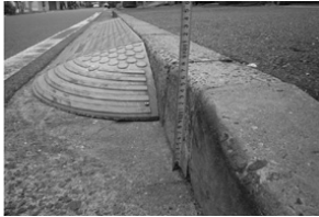
写真-2 歩道の段差
