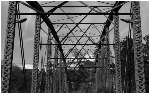
写真9 垂直材, 上横構 上横構は一部継手が腐食して垂れ下がっている
