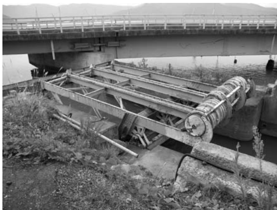
図-6 月浜第二水門のバランスゲート ゲート部の塗装に錆が目立ち始めている (撮影：阿部，2013.10.31)
