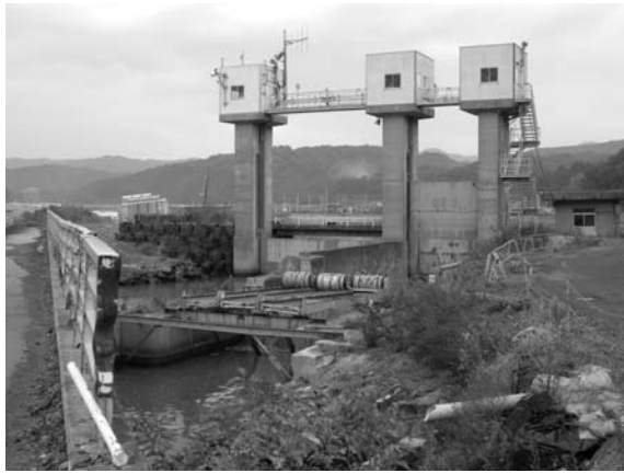
図-5 月浜第二水門の全景 ほぼ被災時のまま存置された状態にある (撮影：阿部，2013.10.31)
