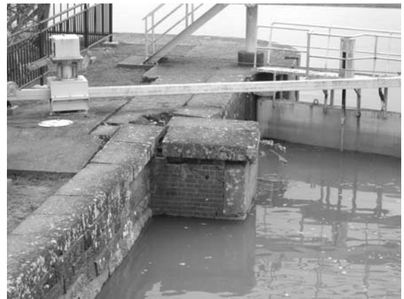
図-3 石井閘門の閘尾部（左岸側） 笠石や煉瓦等の乱れや亀裂が被災時のまま存置されている （撮影：阿部，2013.10.31）
