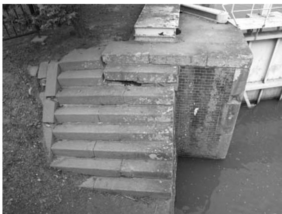
図-2 石井閘門の閘頭部の階段（右岸側） 階段部のズレが被災時のまま存置されている （撮影：阿部，2013.10.31）
