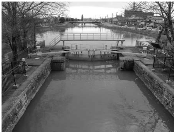
図-1 石井閘門の閘室部（上流側より下流側を望む） 閘室部の石積みに孕みや凹凸がみられる （撮影：阿部，2013.10.31）
