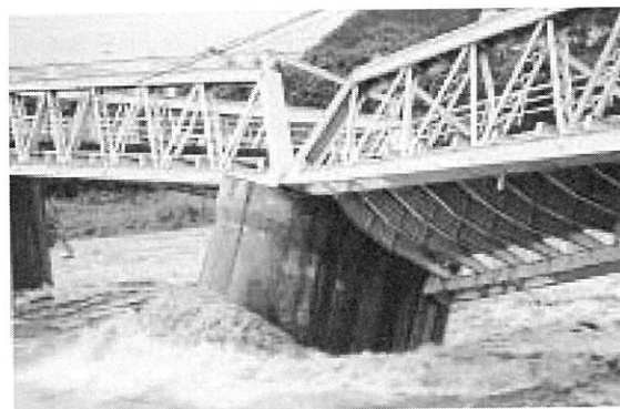
写真 26 平成13年被災状況 21)
