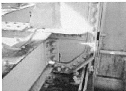
写真-17 横桁取付部の未挿入部材 2002.1 撮影
