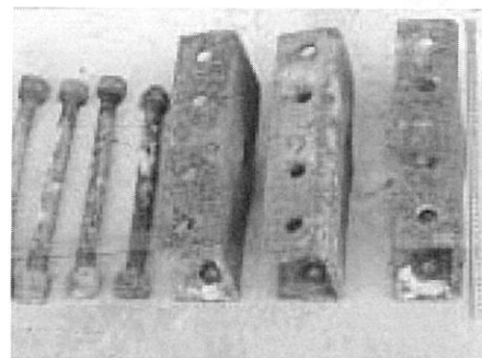
写真-16 経年変形した部材 2005.5撮影
