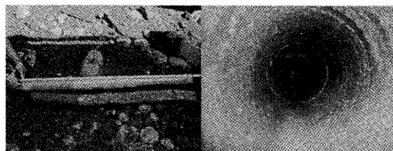
写真-6 水平コアボーリングで確認されたコンクリート (左：壁石と中詰コンクリート、右：ボーリング坑内の様子)
