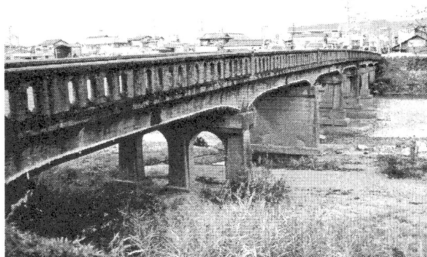
写真-1 補強が未統一な例：土岐橋（岐阜県土岐市、土岐川）
