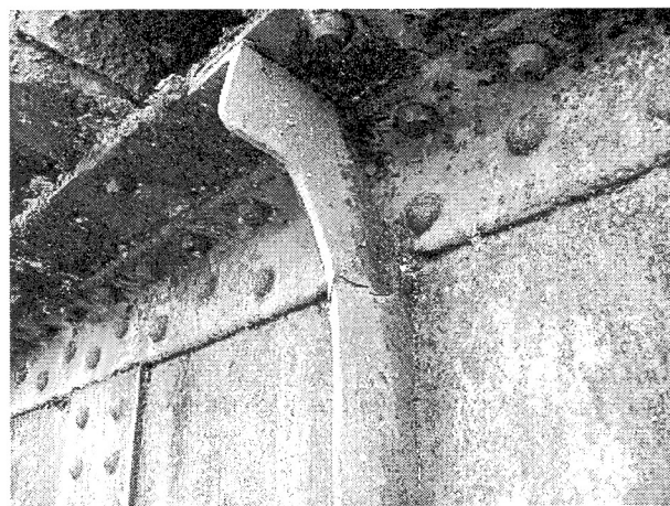
写真－19 亀裂発生状況（垂直補剛材）
