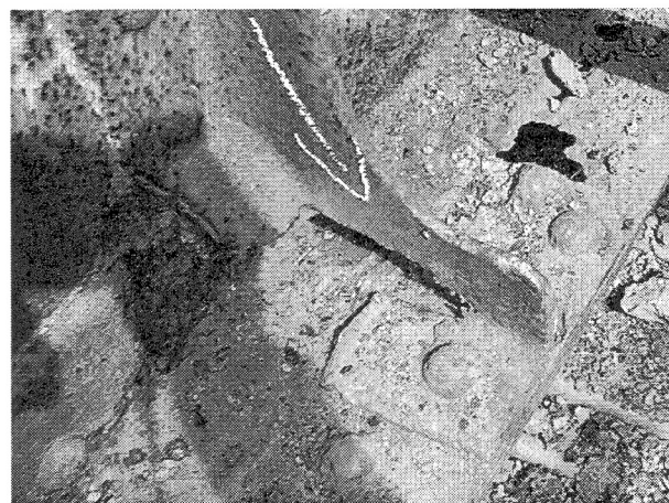
写真－20 垂直補剛材腐食状況
