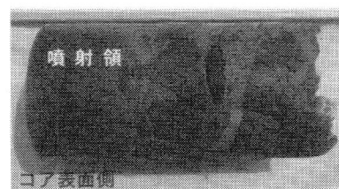
写真－19 中性化試験後のコンクリートコアの状況
