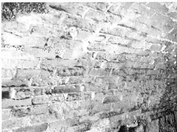
写真-16 アーチ内部におけるレンガの表面剥離
