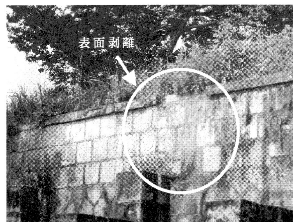
写真-14 郡築三番町樋門の面壁欠損状況
