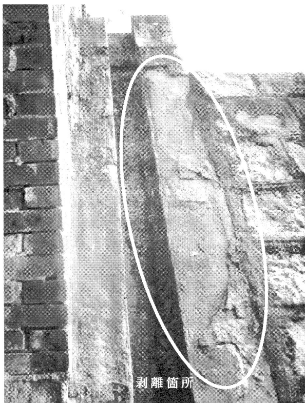
写真-15 郡築三番町樋門の堰板石の表面剥離
