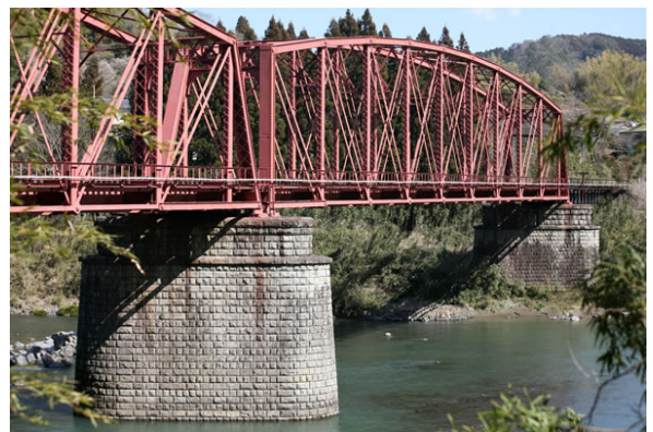
写真-2 球磨川第二橋梁（出典：百年レイル・肥薩線の旅 HP、肥薩線利用促進・魅力発信協議会）
