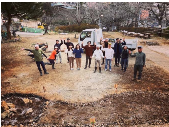
図-15 写真上から、①貯留ピット掘削・整形、②碎石充填、③土壌改良土覆土、植栽植え付け、④竣工した全体像
