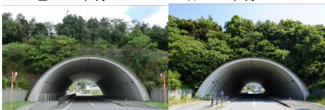
写真-12 県道カルバート付近の盛土 左: 2012年9月 右: 2022年8月
