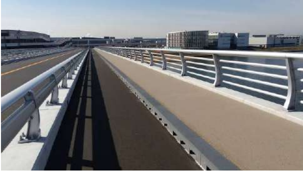
図-5 鋼製排水溝全景
