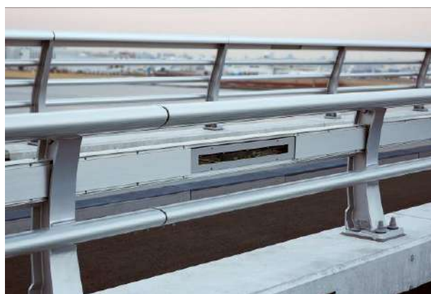
図-15 設置した車両用防護柵
