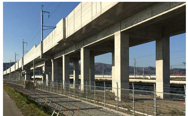
写真-4 ハンチなし(函館車両基地付近高架橋)
