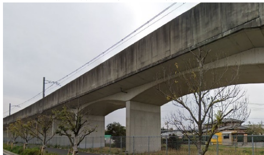
写真-2 つくばエクスプレス線 柏の葉キャンパス駅付近アーチスラブ高架橋 (プレキャストRC高欄・平成17年8月開業)
