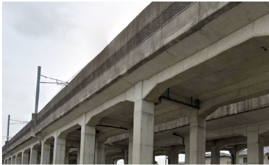
写真-7 JR 東日本 両毛線・栃木駅付近高架橋 (プレキャストRC 製高欄・平成 15 年 4 月完成)
