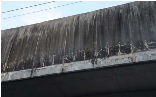
図-19 傾斜を有するコンクリート製高欄の汚れ
