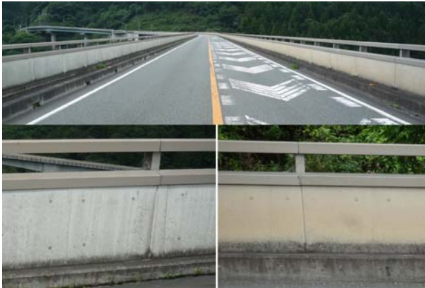
写真-22 主桁壁高欄の内側のエイジング(2014年撮影) 左:歩道側はグレー, 右:車道側は茶色
