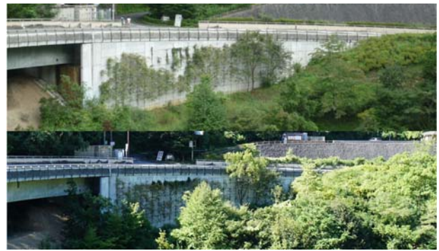
写真-24 補強土壁のエイジング(上:2011年, 下:2018年)
