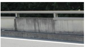
写真-16 天端からの伝え汚れ
