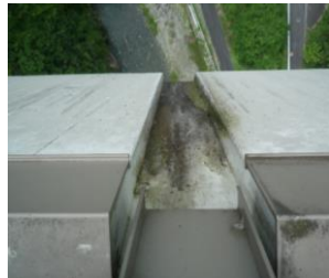
写真-15 縦溝に流れた汚れ
