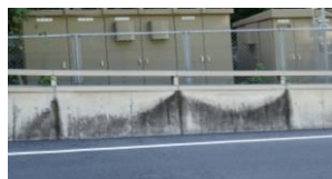
写真-17 伸縮装置付近の汚れ
