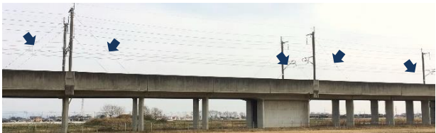
写真-17 上越新幹線深谷地区高架橋(矢印が共振対策バンド)
