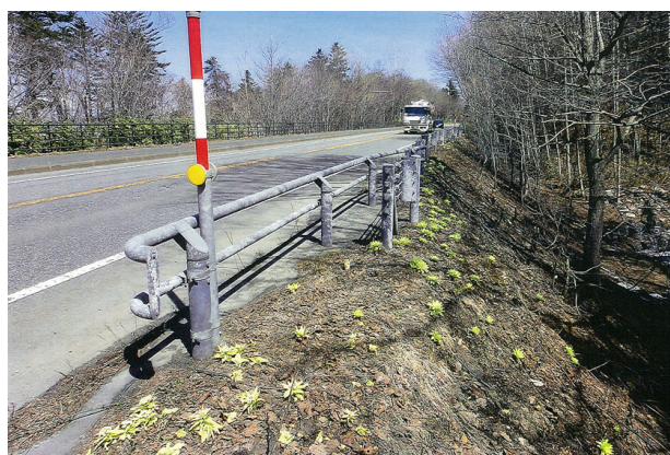
写真-10 リン酸亜鉛処理仕上げの防護柵に発生した白さび
