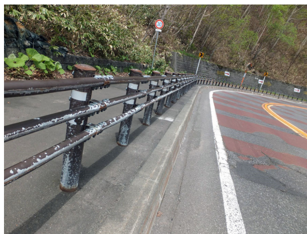
写真-7 除雪作業により塗膜が損傷した防護柵
