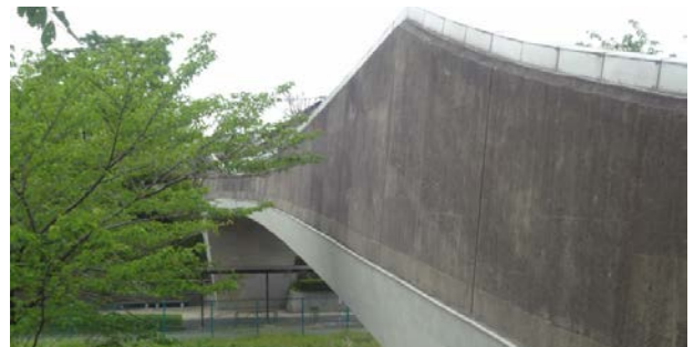
写真-4 内陸部における完成から22年経過した鶴の橋（東京都多摩市）
