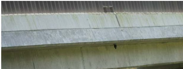
写真-6 ③完成から約2年経過した滝側北の表面性状
