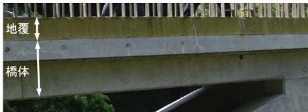
写真-7 ④完成から約3年経過した滝側北の表面性状
