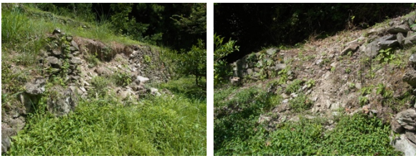
図-3 石積みの崩れ箇所
