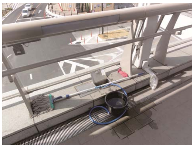
図-9 デッキ地覆部に設置した清掃用水道栓
