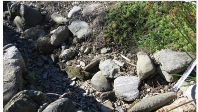
写真-9 石積み損傷箇所
