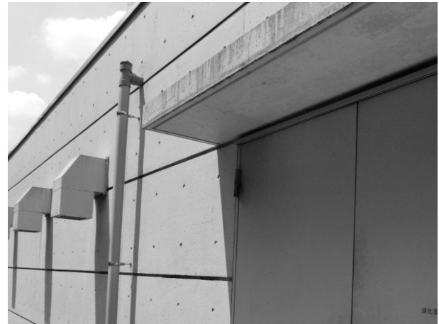
写真-16 鉛直面の汚れ度合いの違い
