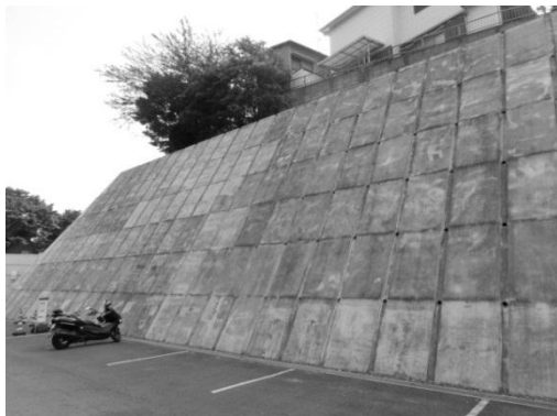
写真 - 9 5年経過した擁壁（⑫区間）
