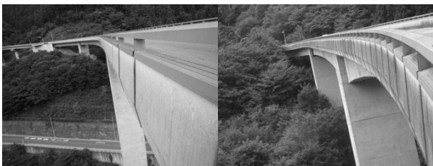
写真-13 方位差による汚れ度合いの違い(左:西向きの面 右:北東向きの面)
