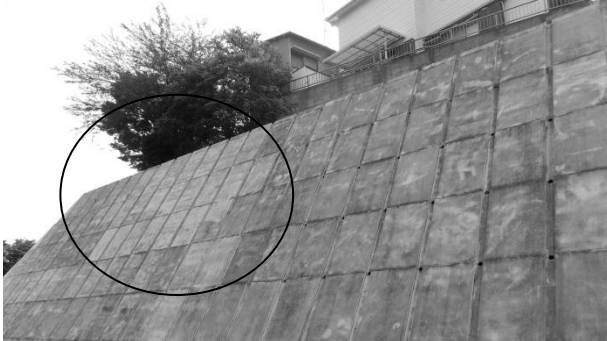
写真-15 局所的に汚れていない面 (㊸区間)
