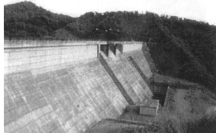
写真-14 鉛直面と勾配面との汚れの進行の違い
