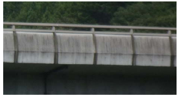
写真-4 壁高欄の汚れの付着状況（全面汚れ）
