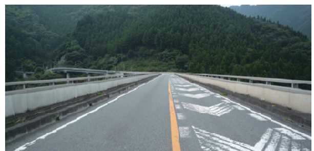
写真-8 壁高欄の内側の表面性状(左右で異なる) (左:歩道あり、右:歩道なし)
