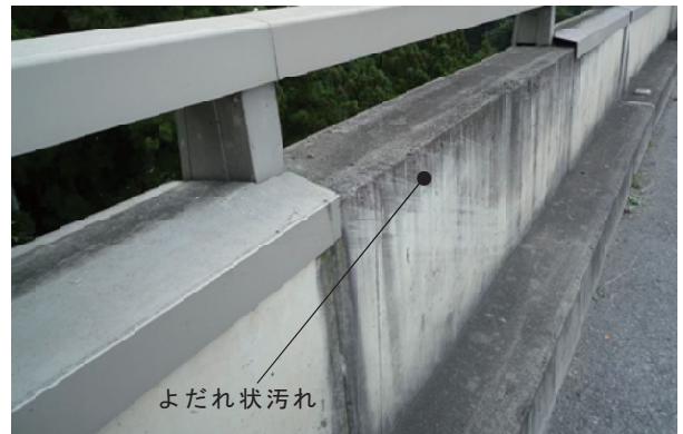
写真-7 高欄カバーの破損部での汚れの付着状況
