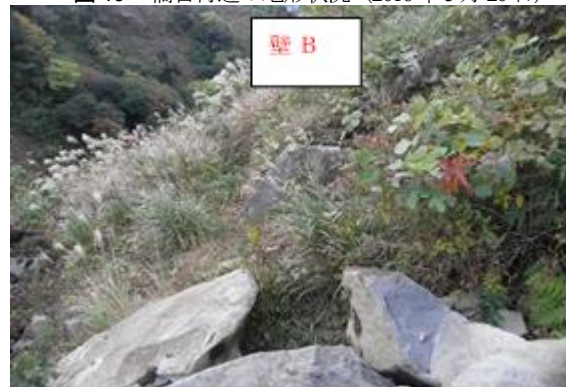
図-11 壁Bの状況(2021年12月)
