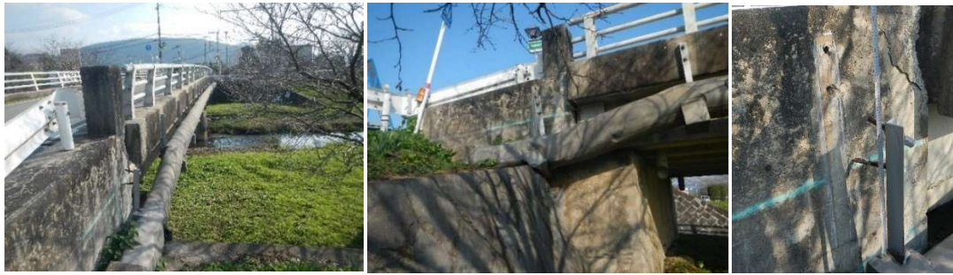
図-1 A橋の実際の被害写真
