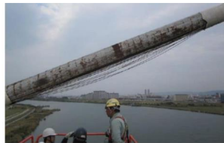
図-1 ケーブル腐食の様子 5)
