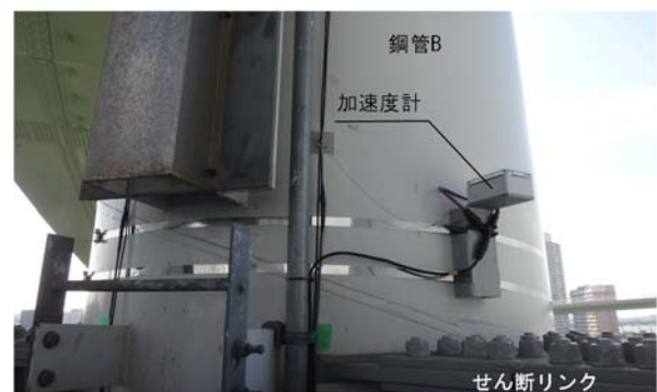
図-5 計測機器の設置状況
