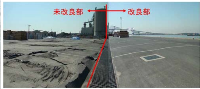
図-2 東京港木材ふ頭岸壁における未改良部の噴砂被害 3)
