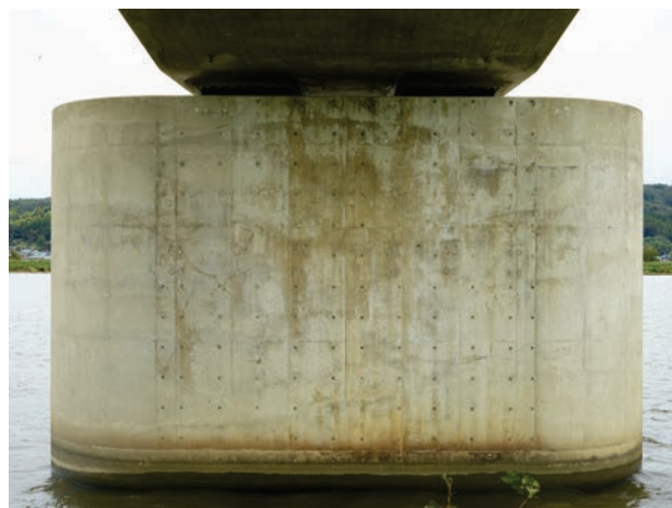
図-2 ひびわれ検出器の検証用画像
