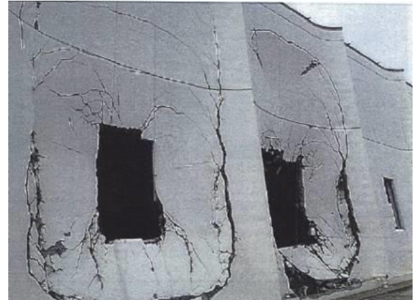
写真-2 曝気槽送風機室外壁の損傷 (仙台市建設局)
