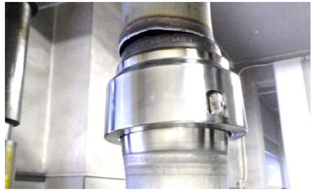
図-11 耐震性鋼管継手の溶接部破断の状態
