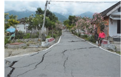
図-5 滑落崖の上流側
