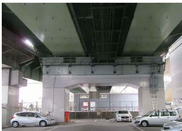
写真-1 地震計が設置された橋脚(P-21)
