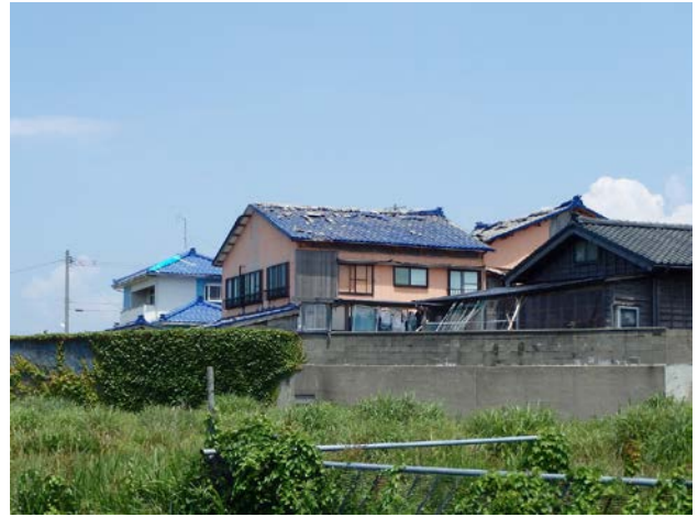
写真-6 府屋地域における木造家屋の瓦屋根の損傷 (N38.516572, E139.533605)
