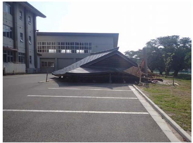
写真-14 大泉小学校（鶴岡市白山）の相撲場の屋根の落下 (N38.615, E139.604167)
