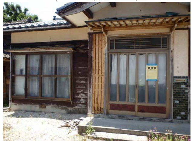
写真-7 府屋地域における古い木造家屋の外壁の剥落 (N38.516733, E139.534405)
