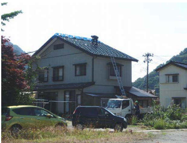
写真-12 湯温海の瓦屋根被害 (N38.615022, E139.60404)
