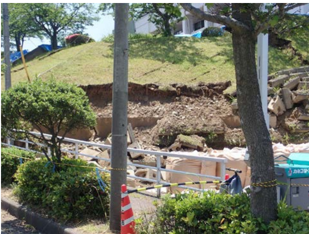
写真-5 府屋観測点付近の盛土の小規模な斜面崩壊 (N38.513557, E139.534312)
