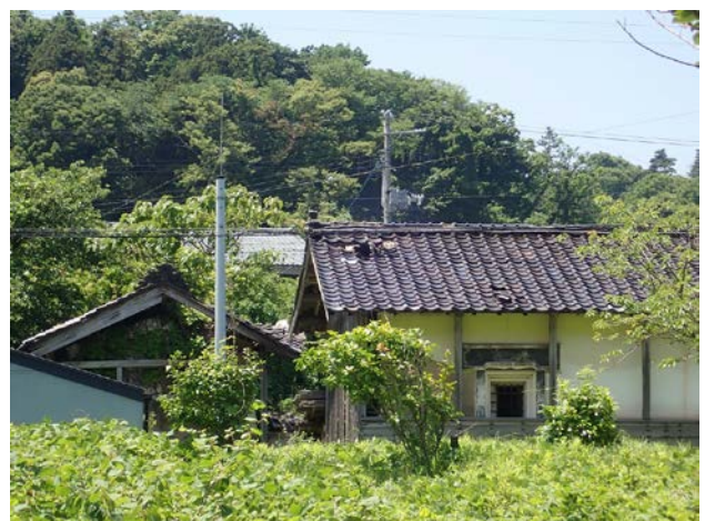
写真-2 木造家屋の瓦屋根の軽微な損傷 (N38.451535, E139.496093)
