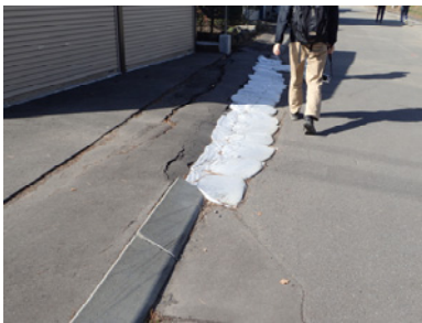
写真-4 勇払郡安平町の地盤沈下被害
