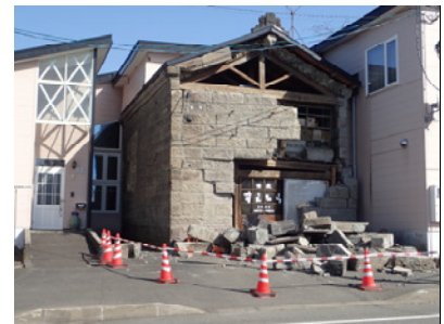
写真-3 勇払郡安平町の建物被害
