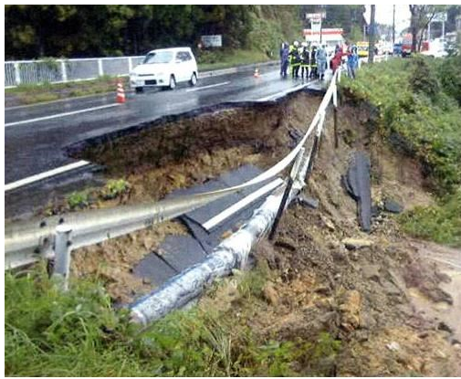
図-1 盛土崩壊に伴う管路露出状況 6)
