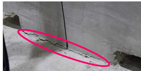
図-10 実験で確認された柱高さ0mmにおける水平ひび割れ
