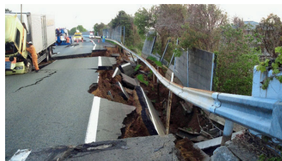
図-1 九州自動車道の道路盛土被害 1)
