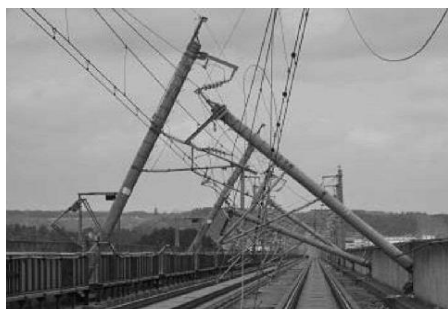
写真-3 電化柱の倒壊 3)
