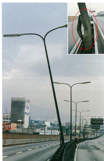
写真-1 照明柱の倒壊 11)
