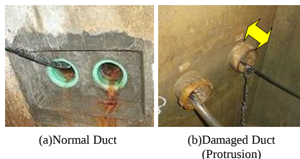
図-3 突出し被災の事例
