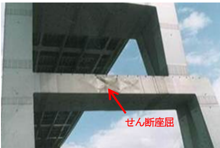
図-1 二層ラーメン橋脚(せん断破壊の例)
